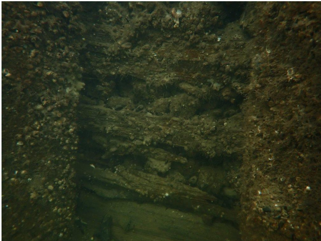
Figur 6: Kraftigt rötangripna horisontella plank mellan 2 pålar.
