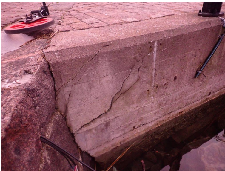
Figur 4: Sprickbildning i betongdäck ovanpå stenkista i landfäste i sektion 0/000 (MarCon Teknik AB).
